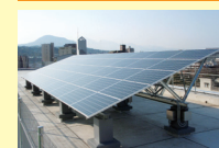
春日町小学校(太陽光パネル)
