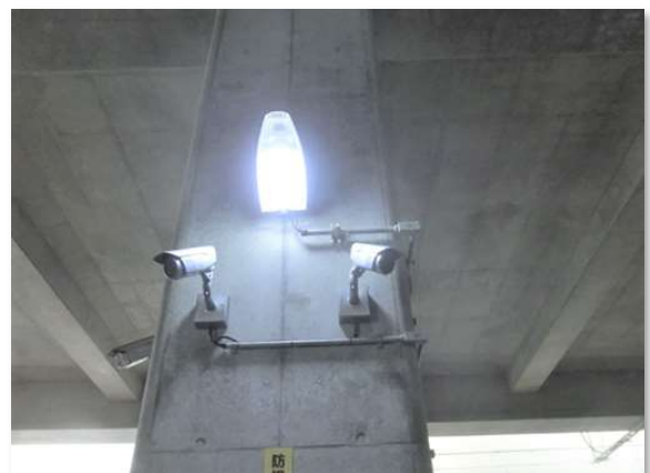
防犯カメラ設置状況
