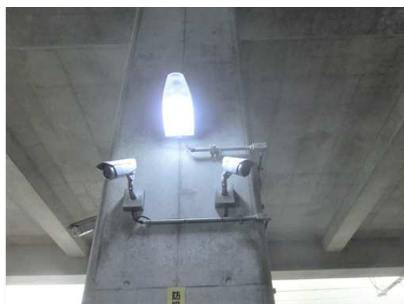
防犯カメラ設置状況
