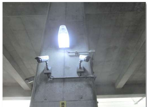
防犯カメラ設置状況
