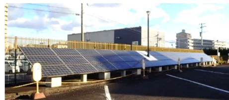
古国府浄水場の太陽光発電
