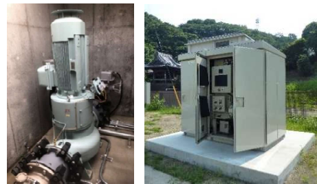
三芳配水場の小水力発電
