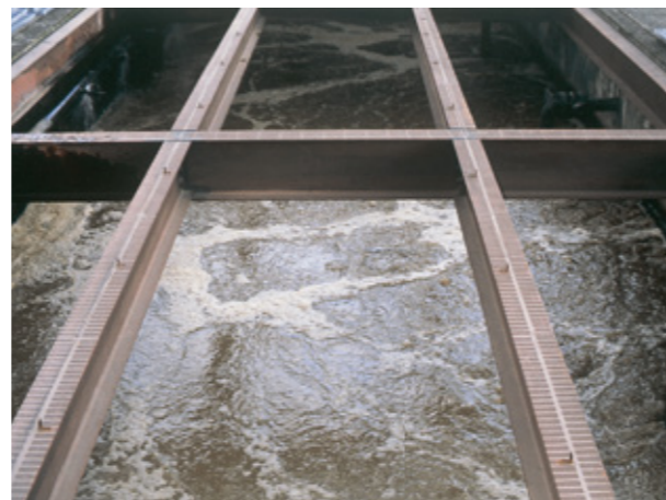
③エアレーションタンク
