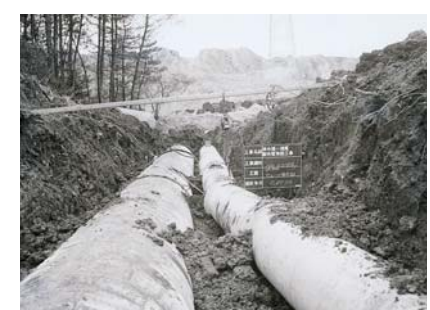
横尾配水池からの口径1,000mm配水管 (左) と500mm排水管 (昭和47年1月撮影)
