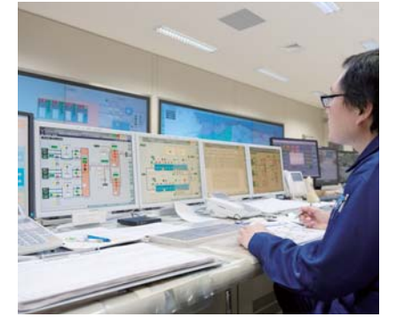
古国府浄水場中央管理室 市内に点在するポンプ所の運転状況等を24時間監視。
