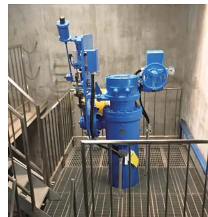
三芳配水場に設置されている緊急遮断弁
