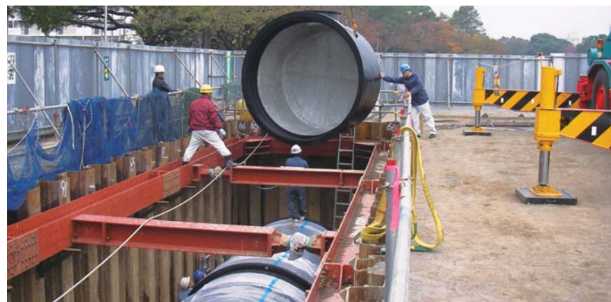
平和市民公園飲料水兼用耐震性貯水槽
