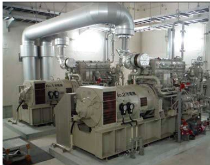
水資源再生センター自家発電機
