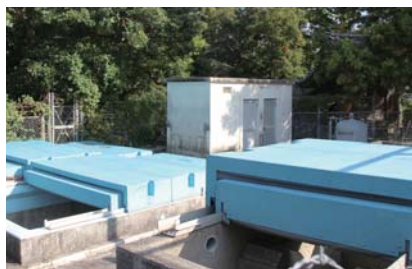
旧田ノ浦浄水場
