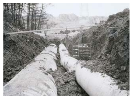
横尾配水池からの口径1,000mm配水管(左)と500mm排水管(昭和47年1月撮影)
