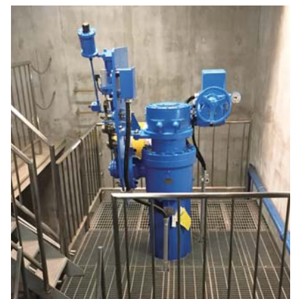
三芳配水場に設置されている緊急遮断弁
