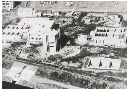
完成間近のえのくま浄水場全景 (昭和44年3月撮影) ▶
