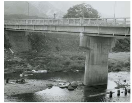
口径250mm鋼管添架工を終了した田尻橋 (七瀬川) (昭和43年11月撮影)
