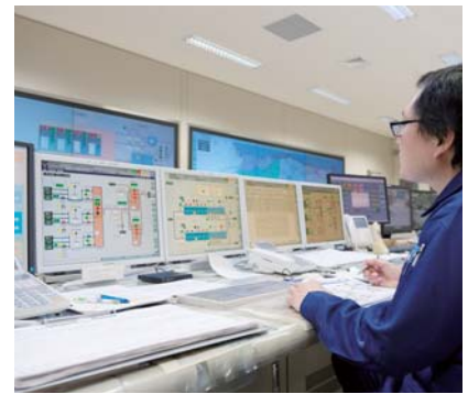
古国府浄水場中央管理室 市内に点在するポンプ所の運転状況等を24時間監視。
