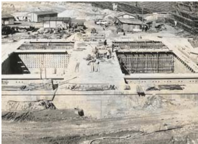
横尾浄水場薬品沈澱池 (昭和47年1月撮影)
