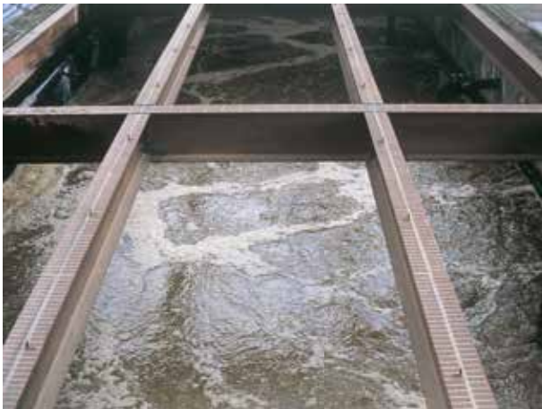
③エアレーションタンク
