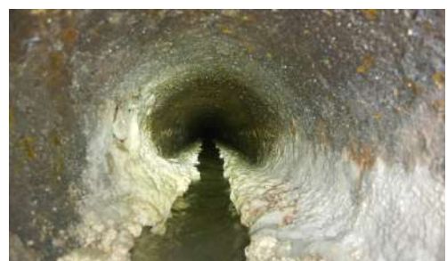
適切な維持管理ができずに油が固まった下水道管
