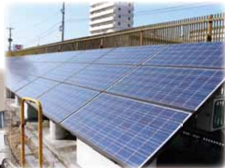
▲古国府浄水場の太陽光発電パネル
