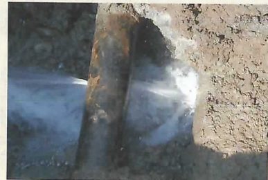
(漏水している水道管)
