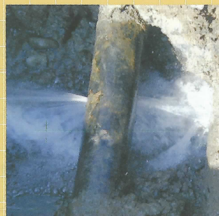
地中の水道管での漏水の例
