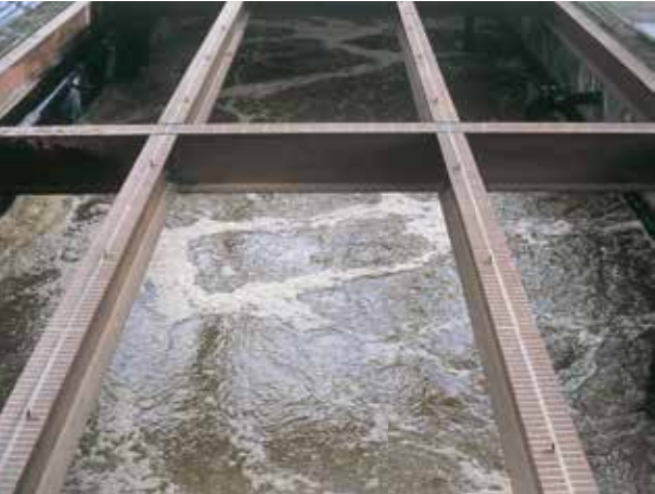
③エアレーションタンク
