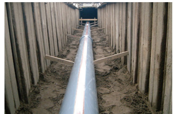
下水道管 (汚水管)
