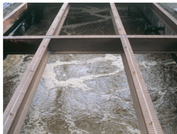
③ エアレーションタンク
