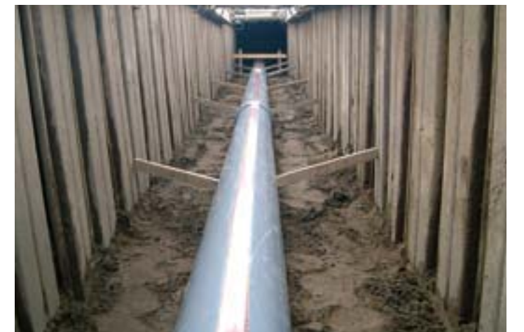
下水管 (汚水管)
