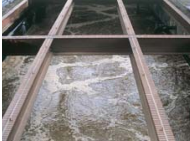
③エアレーションタンク
