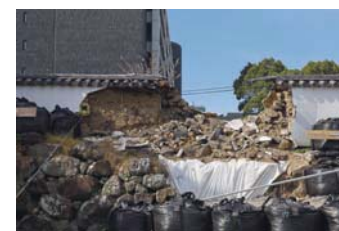
豪雨で倒壊した部分
