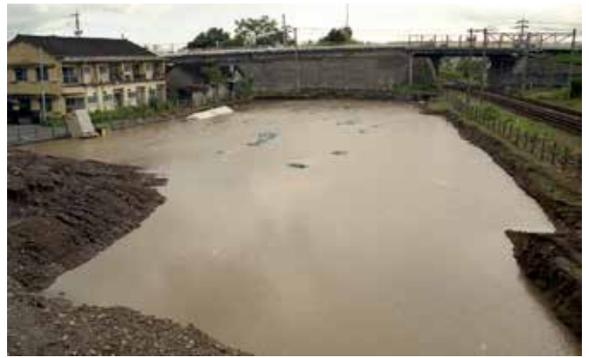
図18 台風10号により冠水した調査現場（平成10年10月18日）
