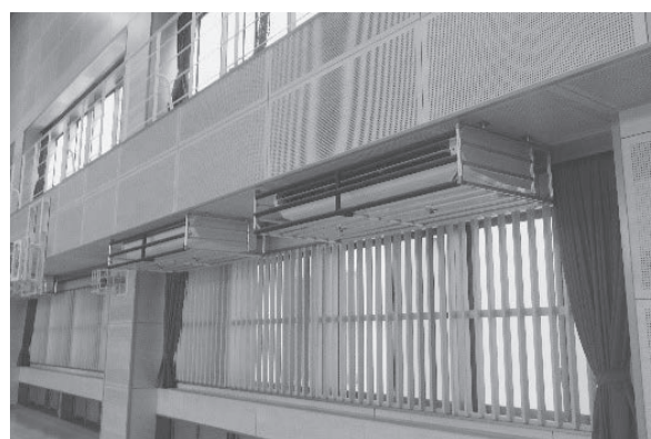
令和4年度の3学期から 金池小学校体育館にて空調設備を運用した
