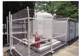
災害対応型液化石油ガスバルクユニット貯槽 (写真は王子中学の施設)
