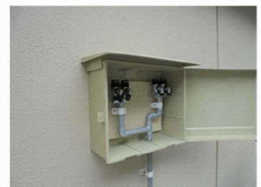
炊き出し用ガス配管
