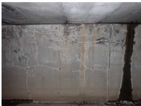
【 橋台の亀甲状ひび割れ(ASR) 】
