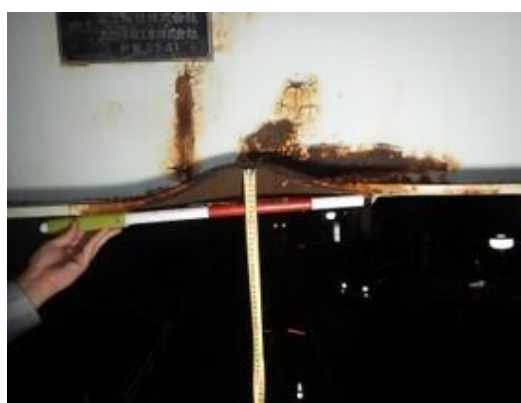
【 主桁の変形(車両接触)・腐食 】
