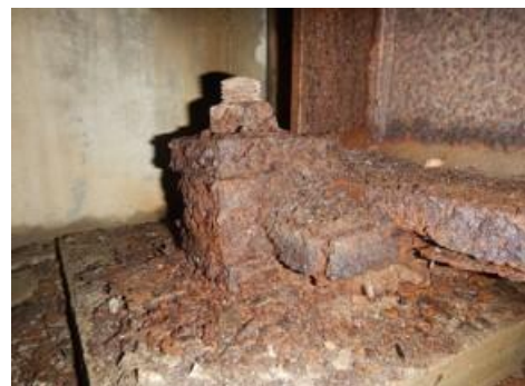
【 支承部の腐食 】
