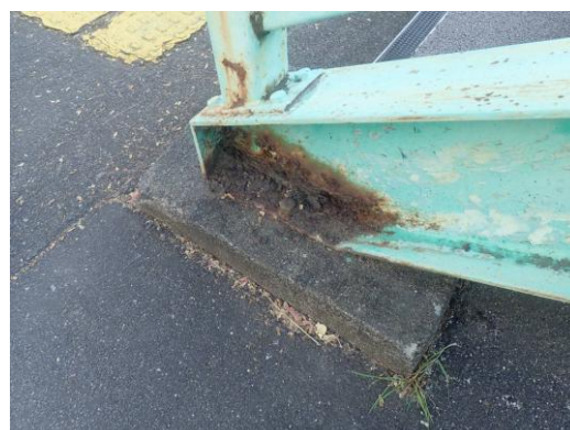
【 階段部基礎の腐食】
