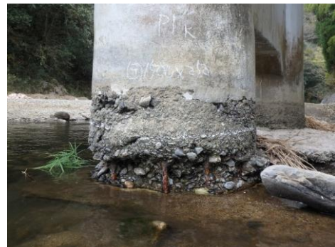
【 橋脚柱基部の剥離・鉄筋露出 】
