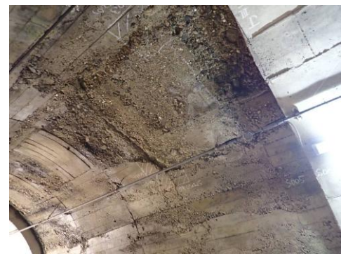
【覆工面のうき・豆板】
