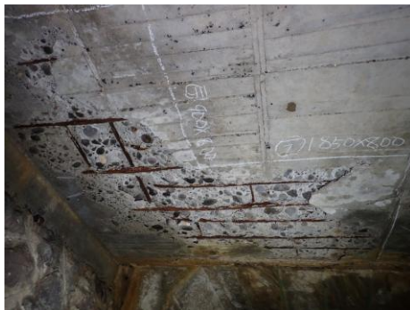
【 床版の剥離・鉄筋露出 】
