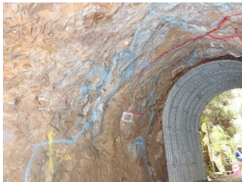
【素掘りトンネルの浮石】
