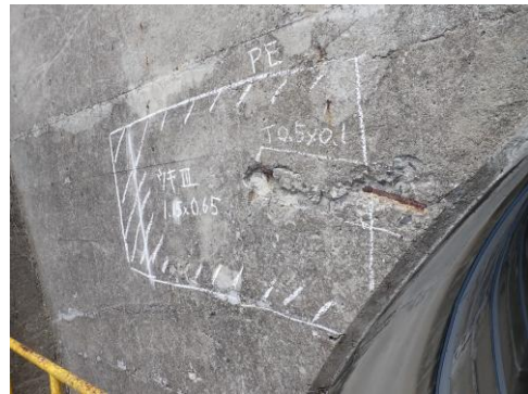
【坑門工のうき・鉄筋腐食】
