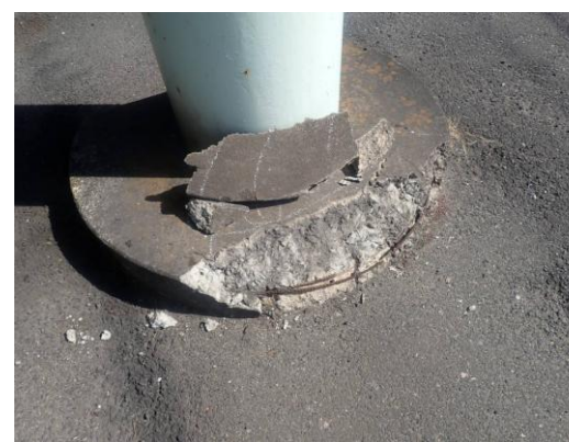
【 橋脚基部のうき・剥離・鉄筋露出 】
