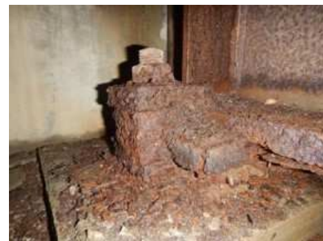
【 支承部の腐食 】
