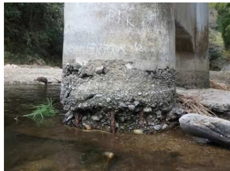
【 橋脚柱基部の剥離・鉄筋露出 】
