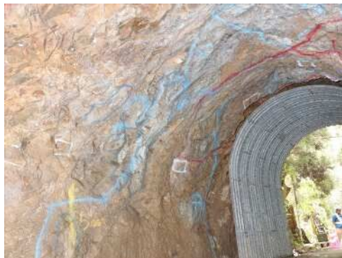
【素掘りトンネルの浮石】
