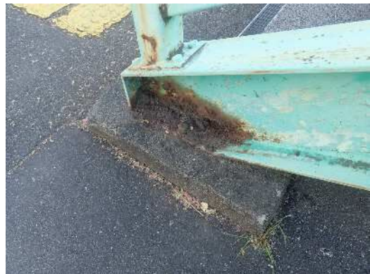
【 階段部基礎の腐食】
