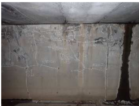
【 橋台の亀甲状ひび割れ(ASR) 】
