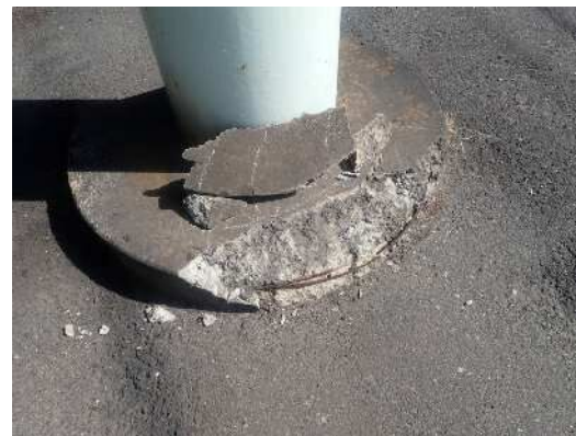
【 橋脚基部のうき・剥離・鉄筋露出】
