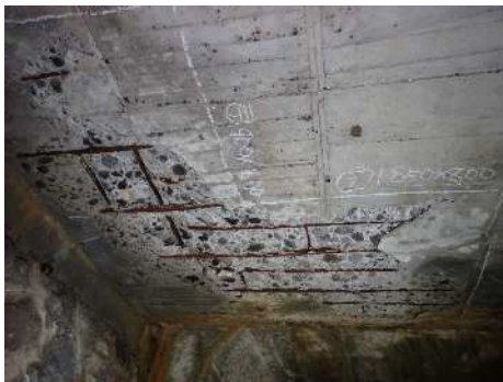
【 床版の剥離・鉄筋露出 】
