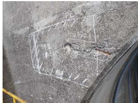
【坑門工のうき・鉄筋腐食】
