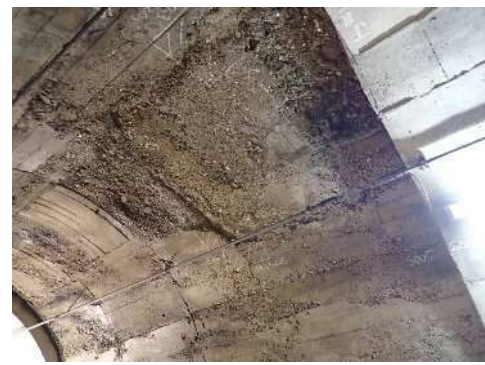
【覆工面のうき・豆板】
