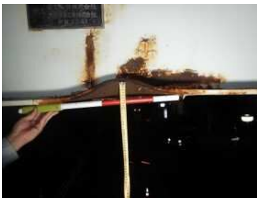
【 主桁の変形(車両接触)・腐食】
