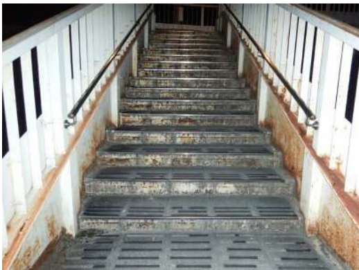
【 階段部の防食機能劣化・腐食】
