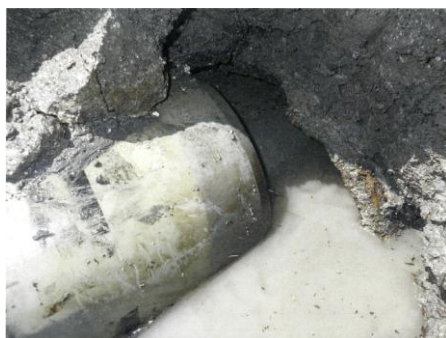
空洞化原因（集水桝取付管破損）
