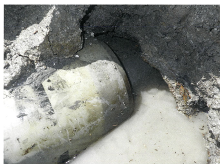
空洞化原因(集水桝取付管破損)
