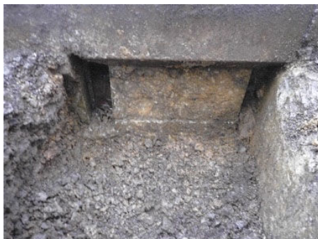
空洞化原因(集水柵の破損)
