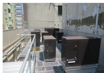
2F 地上機器集約設置状況
