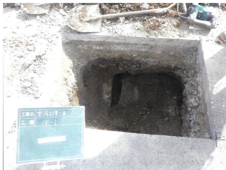
空洞化原因(埋設管の破損)
