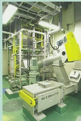
沈砂洗浄装置
