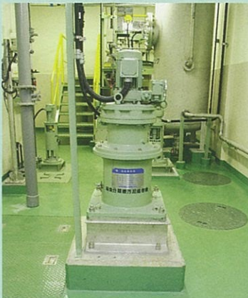
凝集処理設備
