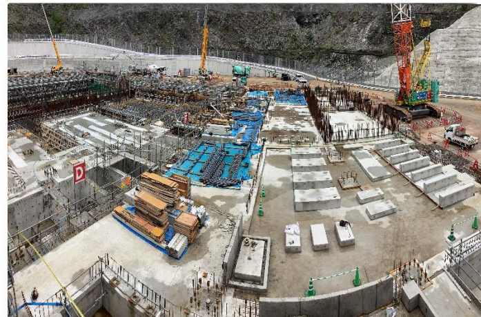
④焼却施設：灰ピット周り
