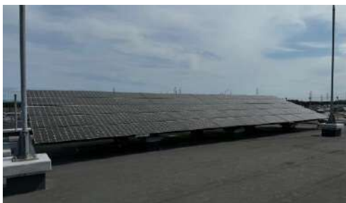
坂ノ市小学校に設置されている太陽光発電パネル
