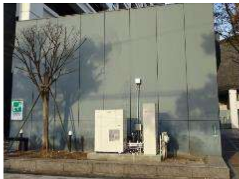
市役所本庁舎の業務用燃料電池
