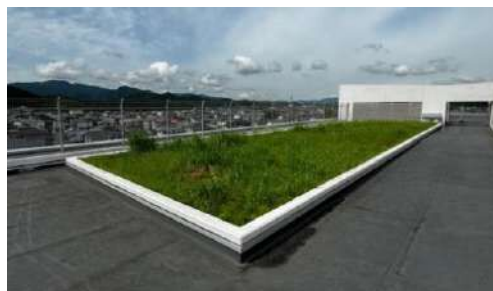
坂ノ市小学校に設置されている屋上緑化
