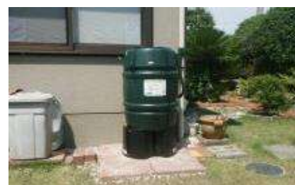
雨水貯留施設
