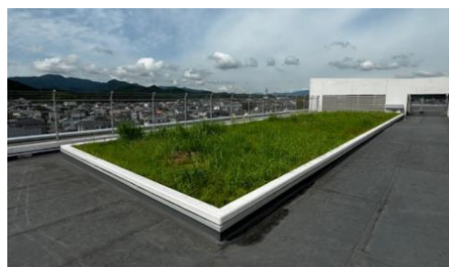
坂ノ市小学校に設置されている屋上緑化
