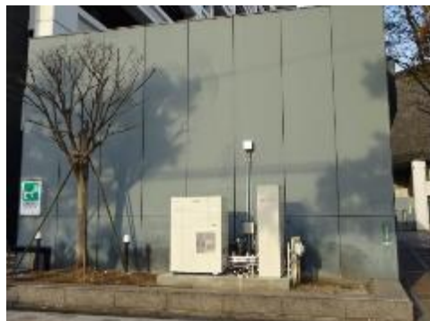
市役所本庁舎の業務用燃料電池
