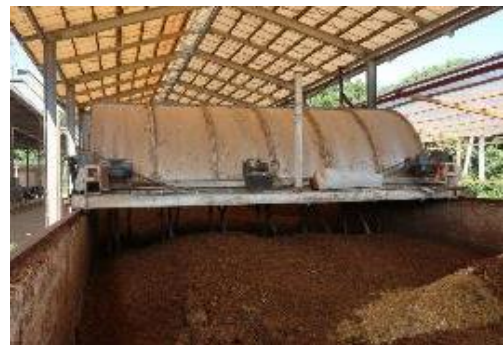
畜産農家の堆肥処理施設
