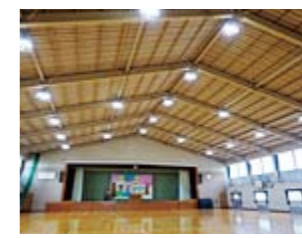
LED照明 (田尻小)
