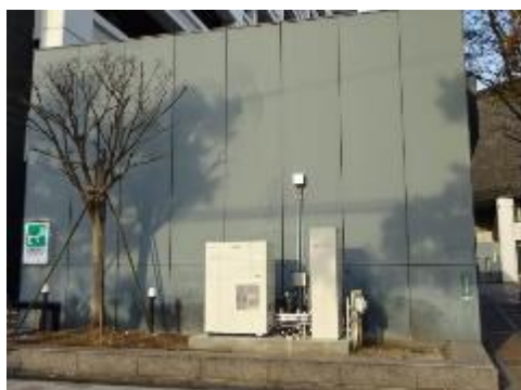
市役所本庁舎の業務用燃料電池
