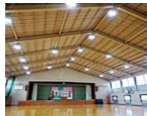
LED照明 (田尻小)
