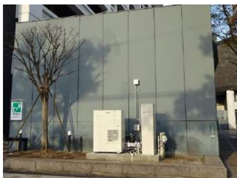
市役所本庁舎の業務用燃料電池
