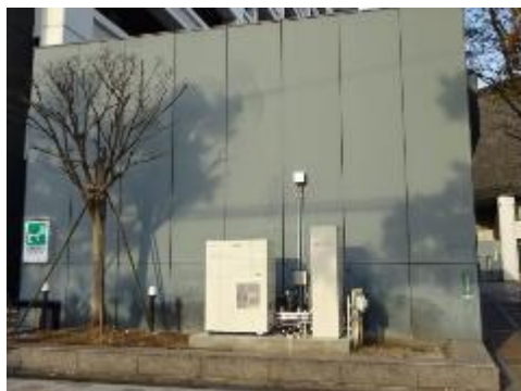
市役所本庁舎の業務用燃料電池
