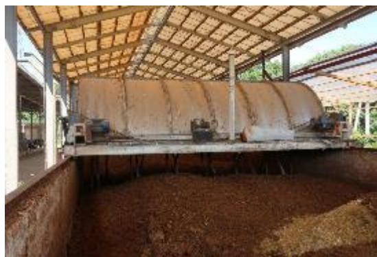
畜産農家の堆肥処理施設
