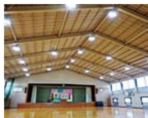
LED照明 (田尻小)
