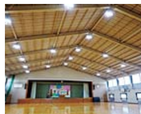
LED照明 (田尻小)
