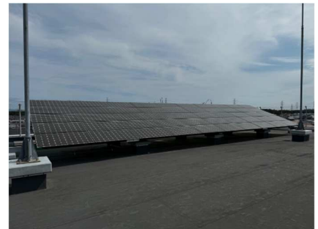
坂ノ市小学校に設置されている 太陽光発電
