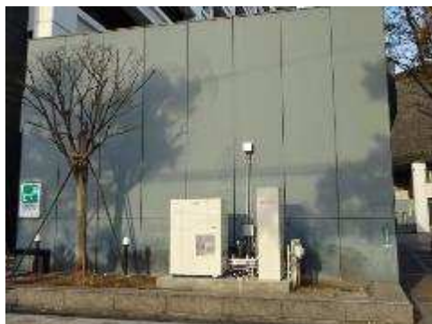
市役所本庁舎の業務用燃料電池
