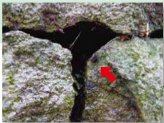
石積壁の 隙間
