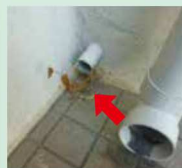
建物の壁 の隅
