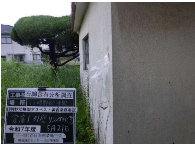
旧明野幼稚園 倉庫1 外壁 リン酸吹付③
