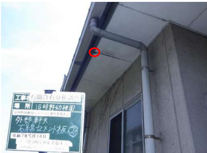
旧明野幼稚園 軒天 石綿セメント板②
