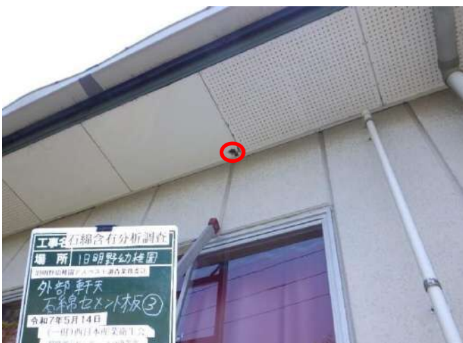
旧明野幼稚園 軒天 石綿セメント板③
