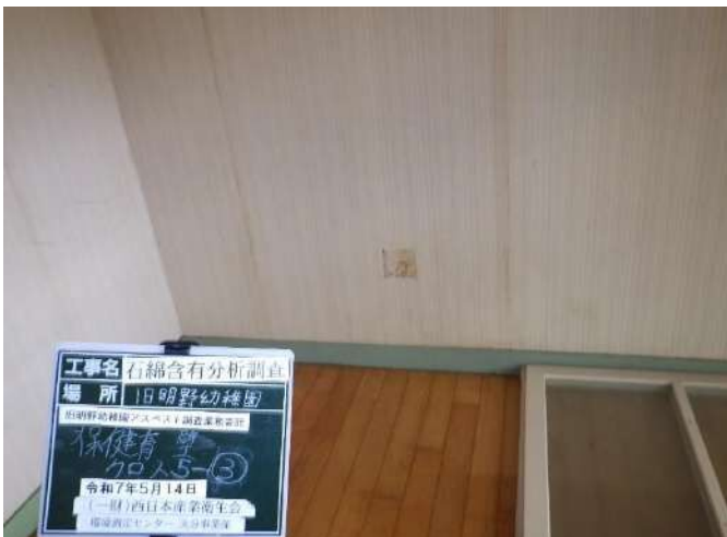
旧明野幼稚園 保健室 壁 クロス5③
