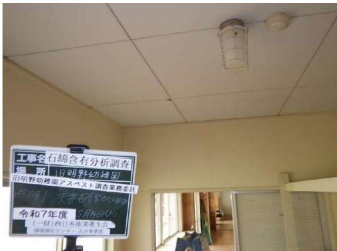
旧明野幼稚園 遊具庫1 天井 石綿セメント板VP塗り②
