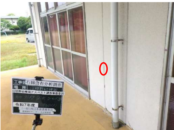
旧明野幼稚園 外壁目地 コーキング③
