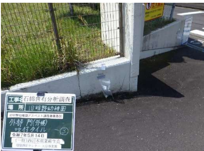
旧明野幼稚園 門(外塀) 吹付タイル③
