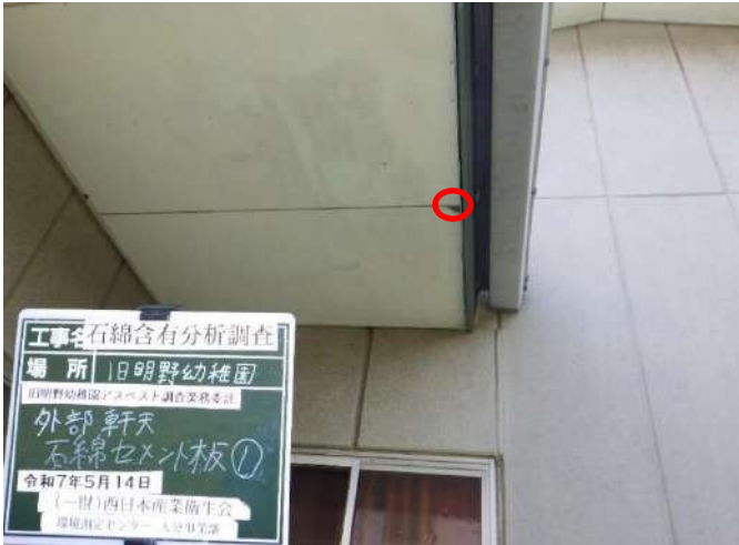
旧明野幼稚園 軒天 石綿セメント板①
