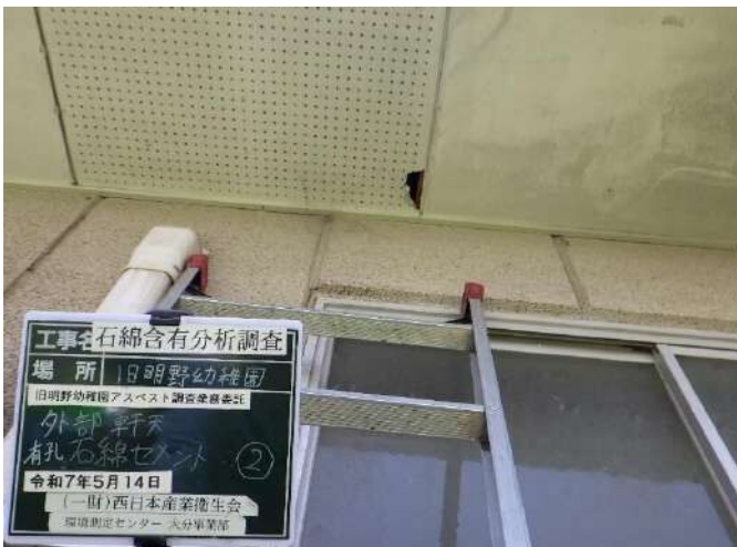
旧明野幼稚園 軒天 有孔石綿セメント板②
