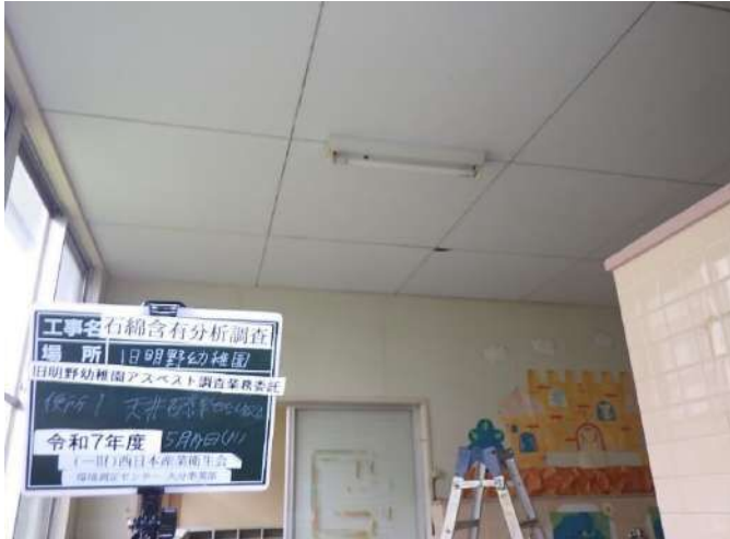
旧明野幼稚園 便所1 天井 石綿セメント板VP塗り①
