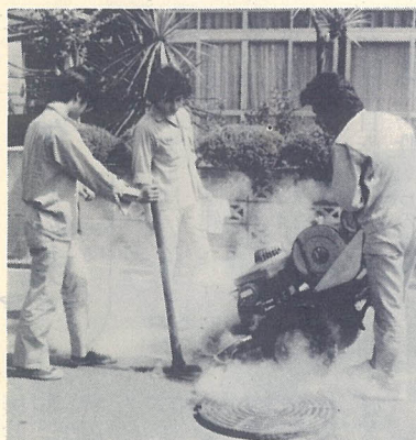
マンホールの中のゴキブリ退治 (明野西町で)
