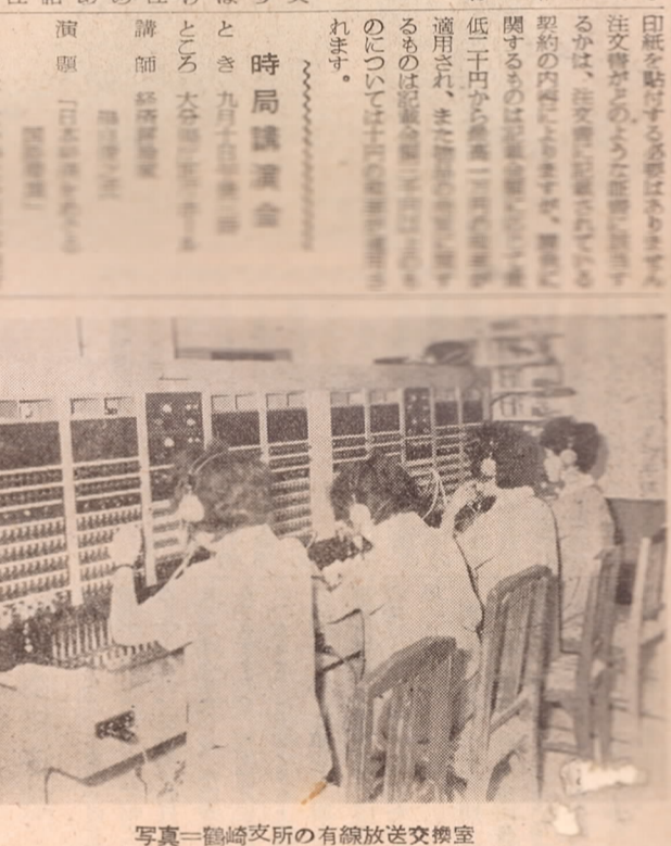
写真一 鶴崎支所の有線放送交換室
